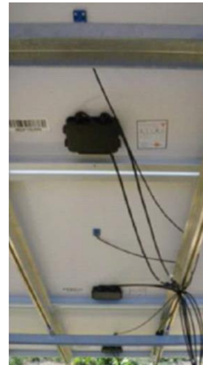
Figure 56 : Câbles des modules
